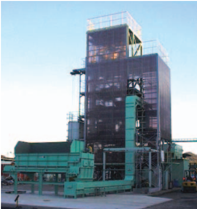
写真1 MSFB ボイラパイロットプラント MSFB Boiler Pilot Plant
