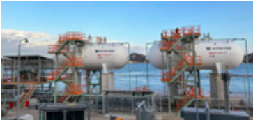
アンモニア供給設備
