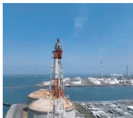
図4 フレアスタックの点火状況確認
