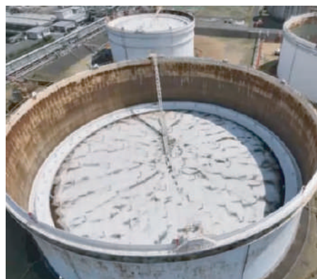
図3 ナフサタンク外面腐食確認
