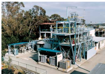
天然ガスハイドレート実証プラント
