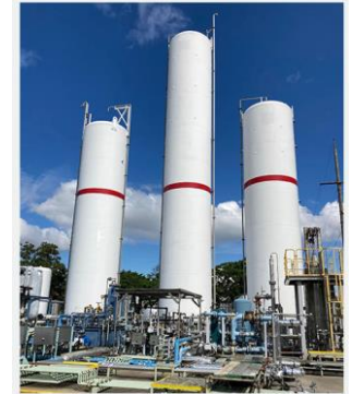
(LNG燃料供給設備)
