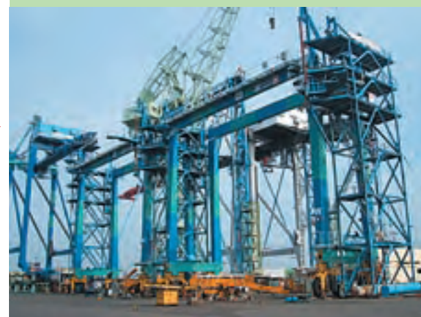
写真が、ポーテナー体上架装置です。
